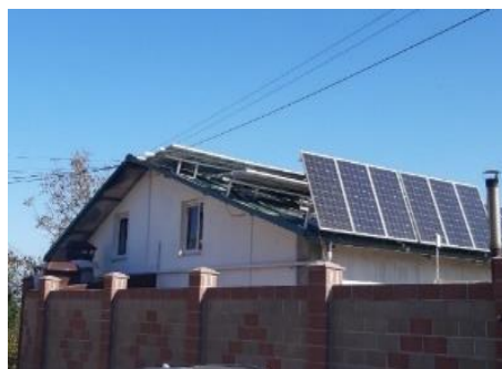
Рисунок 4 - Повреждение кровли и панелей солнечных батарей
